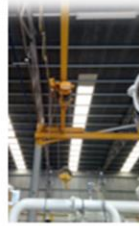
Traveling Crane 5 Ton
